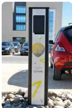
Une des bornes de recharge de véhicules électriques utilisées pour le démonstrateur terrain.
